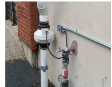
Figura 4. Ejemplo de un sistema de mitigación de vapores recientemente instalado en el c. c. Savings Square.
