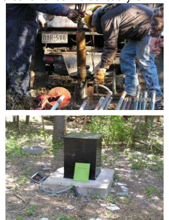
Figura 2. En Enero de 2009, la EPA aseguró una noria abandonada.
