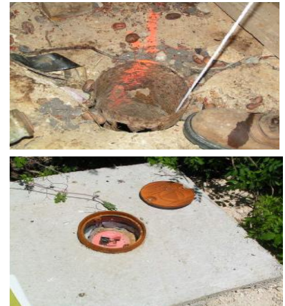
Figura 4. La foto de arriba muestra la tapa de una noria con la superficie corroída y la placa de concreto rota. La foto de abajo es la de una noria protegida con un nuevo acabado en la superficie (i. e., placa de concreto) y tapa de cierre.
